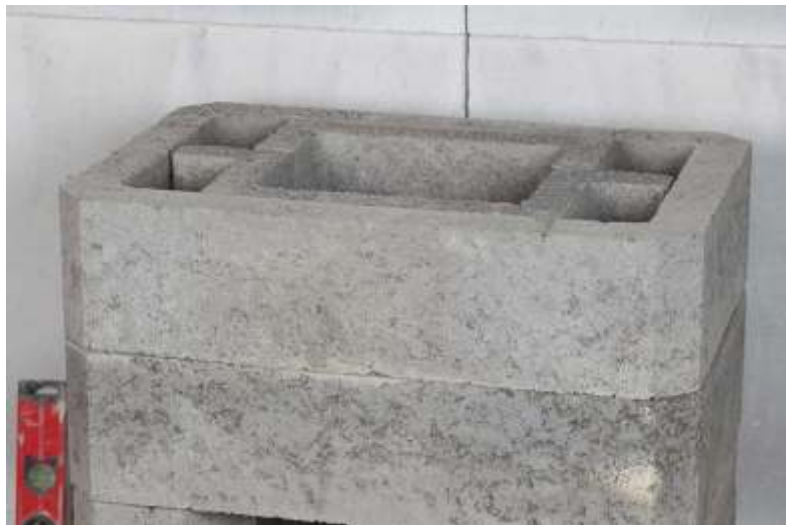
10. Paigalda sobituselemendid. Kontrolli õige paigaldusjärjekord lk.2 joonise järgi. NB! Veendu, et küljekanalitesse ei ole jäänud segujääke!
